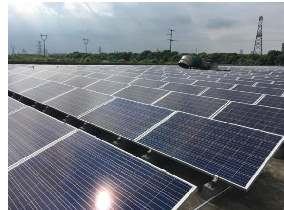
工場の屋上に設置されたソーラーパネル
