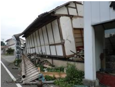
東日本大震災にて崩壊した松永窯(福島県浪江町)
