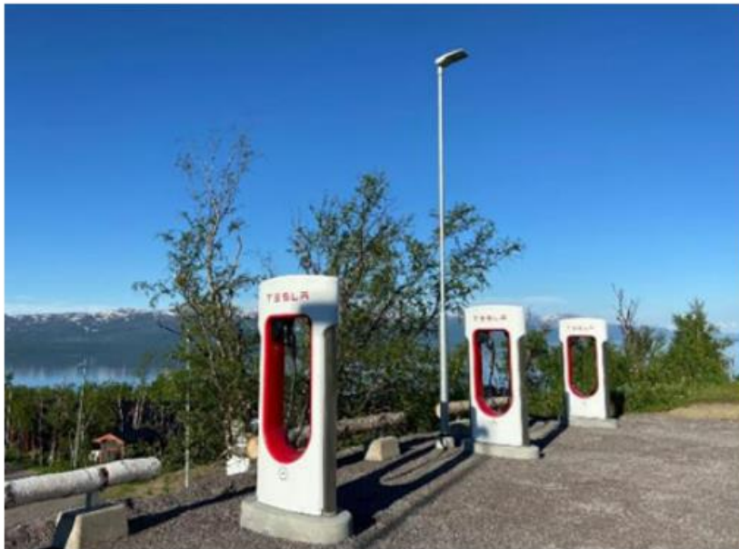
スウェーデン北部の小村にある宿泊施設のテスラの充電ポイント。 同国もEUの中でBEVの普及が最も進んでいる国の1つだ。(ジェットロ撮影)
